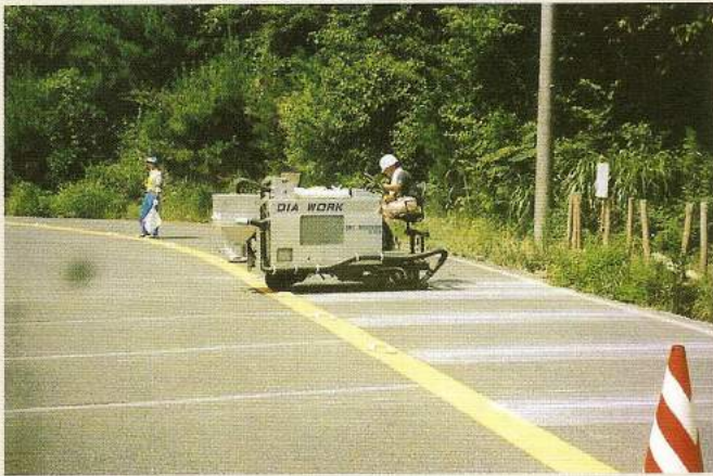
発注元：滋賀県大津市 施工地：滋賀県大津市内 施工期：平成11年7月 用途：ローリング族対策 施工タイプ：縦溝108mm(ピッチ500mm~1500mm)
