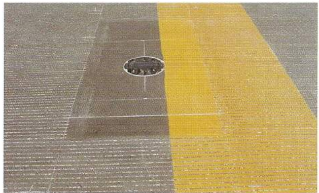
空港誘導灯火周り
